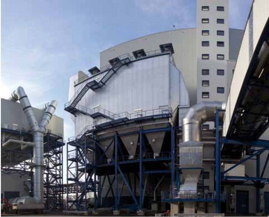
Rund eine halbe Milliarde Euro hat MVV Energie in den letzten 20 Jahren in ihren Standort auf der Friesenheimer Insel in Mannheim investiert – unter anderem in den neuen Heizkessel.
